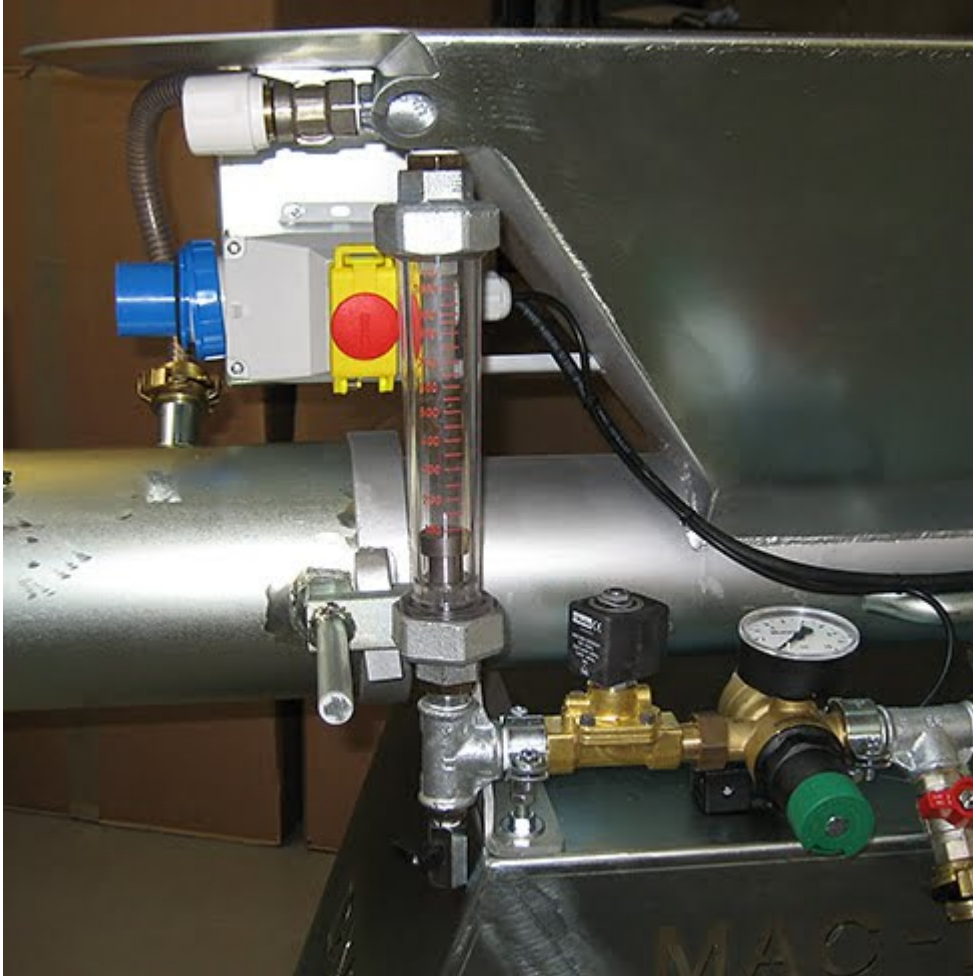
particolare pompa acqua e flussimetro
